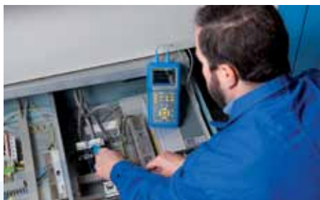
Ici, le technicien intervient sur le process d'une machine commandant des plateaux de composants.
